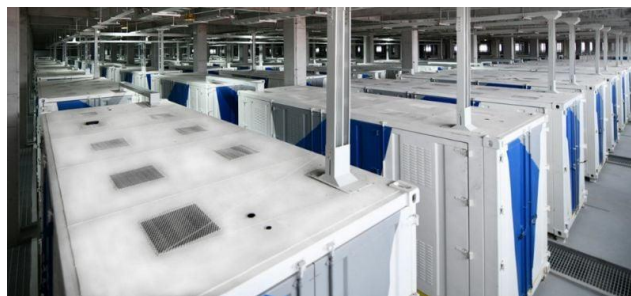
Figura 5. Fotografía del sistema de baterías de flujo redox más grande del mundo instalado en China en 2022. 17
